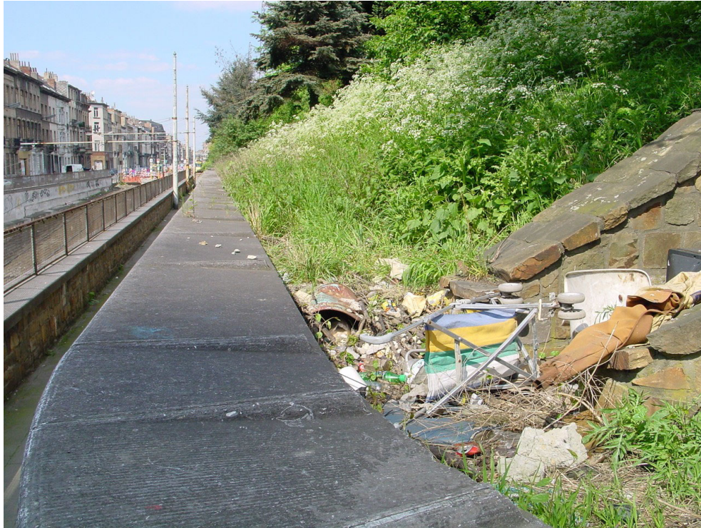
Le talus : mal entretenu, il accueille les dépôts clandestins. Het talud : slecht onderhouden met sluikstorting.
